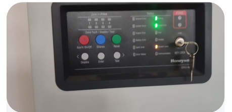
06 / Yangın alarm paneli
